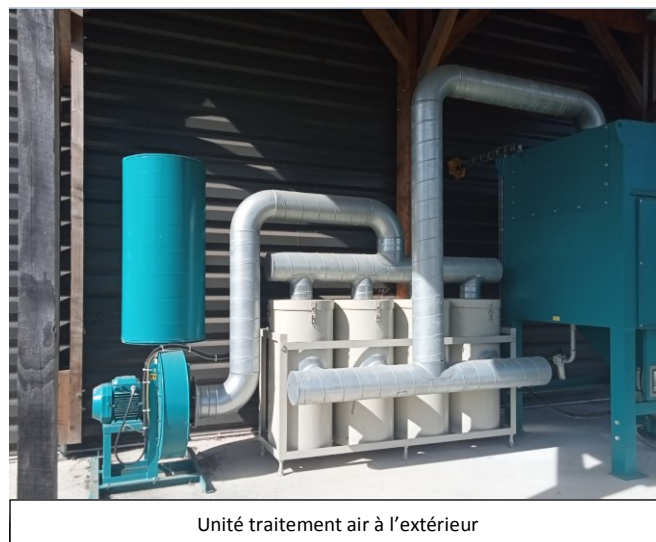
FIGURE 6 : LIGNE TRAITEMENT LCD SUR LE SITE
