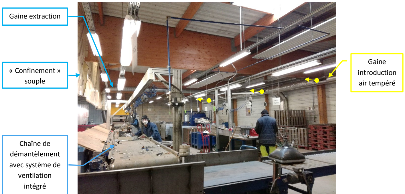
FIGURE 7 : LIGNE DEMONTAGE ECRAN CATHODIQUE AVEC LES ELEMENTS DU SYSTEME DE VENTILATION DANS L'ATELIER
